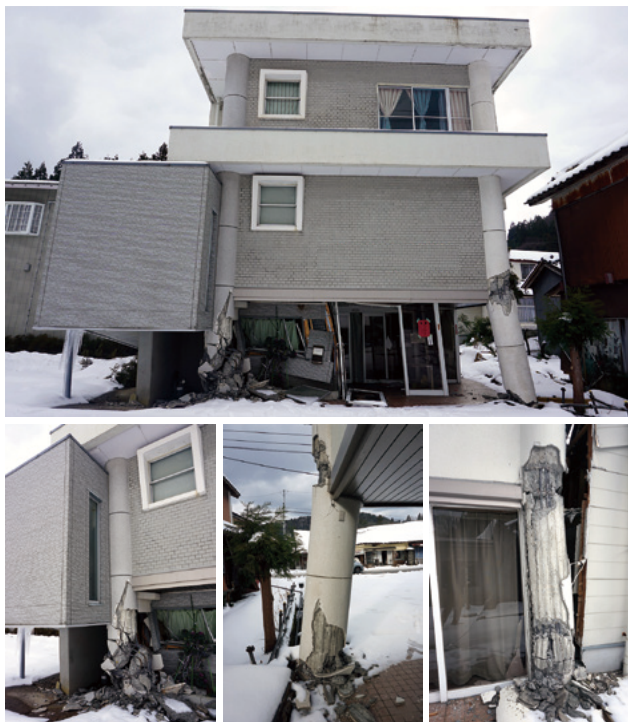
写真9 柱がせん断破壊したRC造病院
