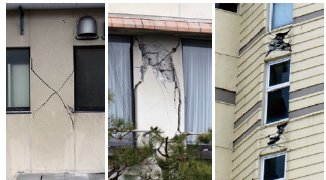
写真2 短柱および短スパン梁のせん断破壊
