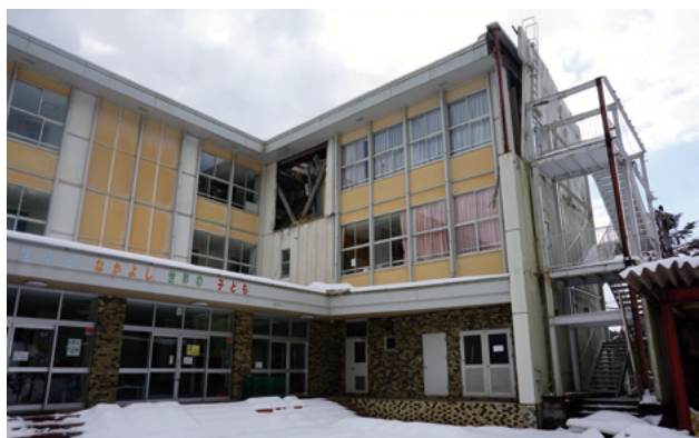
写真10 外壁が落下した鉄骨造学校校舎
