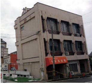
写真4 傾斜したRC造ビル
