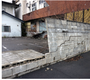
写真5 ブロック塀の転倒
