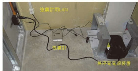
写真1 強震計の設置状況
