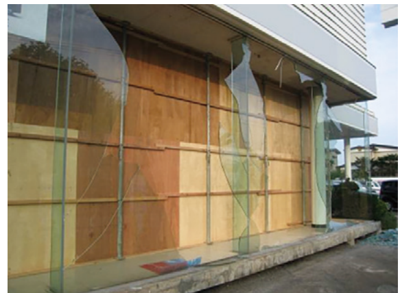
図5 ガラススクリーン構法の地震被害 5)
