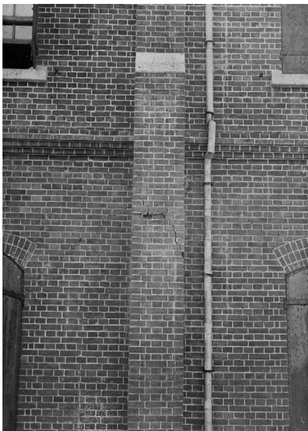
写真10 東北側壁封角線状亀裂 注2)
