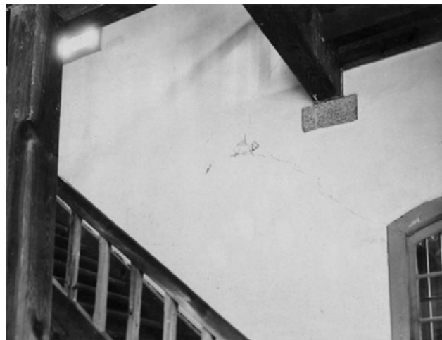
写真13 東北側壁封角線状亀裂 注2)
