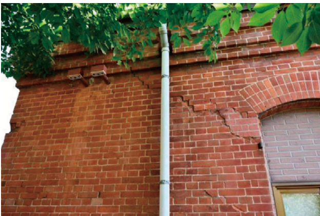
写真16 現在の施設課事務所東北側壁面のひび割れ
