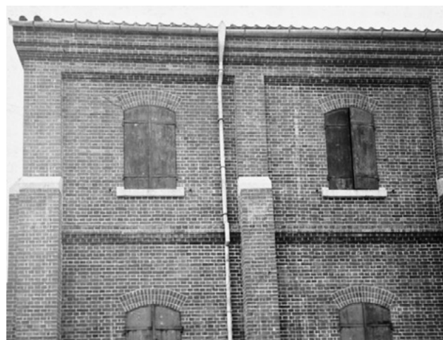
写真14 東北側壁封角線状亀裂 (47) ノ外部 注2)
