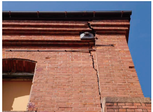
写真17 現在の第九庫南西隅の外壁ひび割れ
