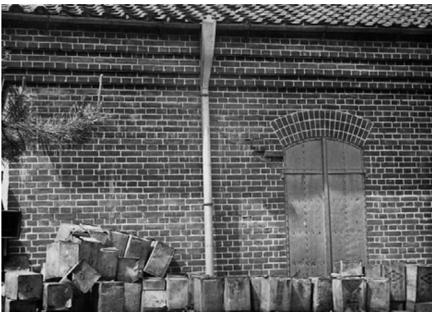
写真15 需品庫煉化平家倉庫 東北側壁亀裂 注2)
