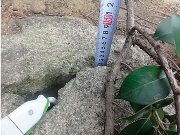
図6 平成28年に新たに見つかった亀裂
