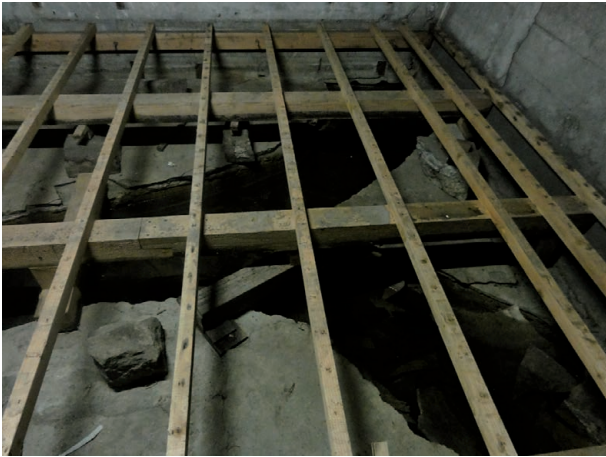
図6 指揮連絡室の床の様子
