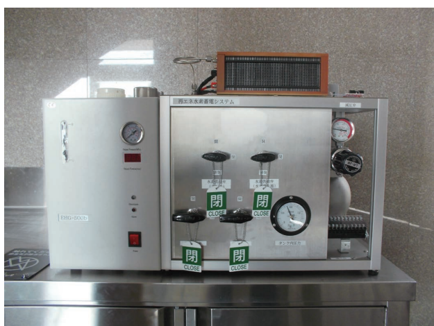
図10 水素蓄エネ発電システム (エノア製)
