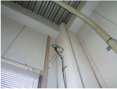
図19 水素ガスボンベ用水素ガスセンサー
