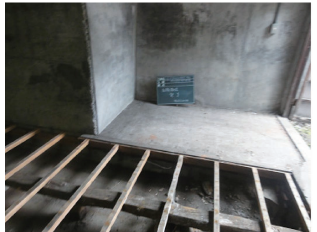
図7 今回新たに見つかった亀裂の内部
