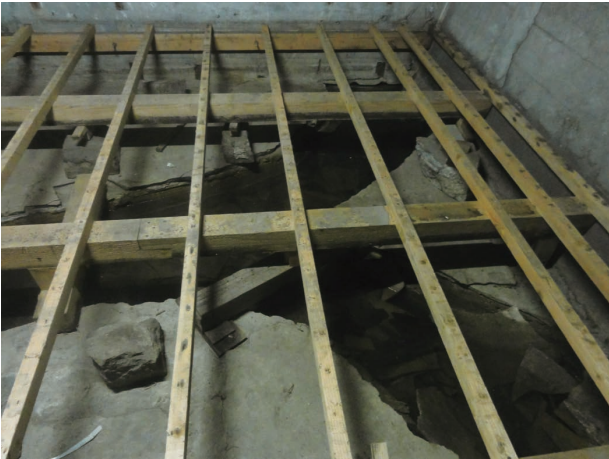
図9 指揮連絡室の床の様子
