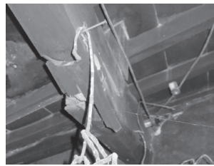
写真2 腐食による損傷
