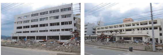
(a) 東棟 (b) 西棟 写真9 浸水深さの確認 (S病院, 南三陸町)
