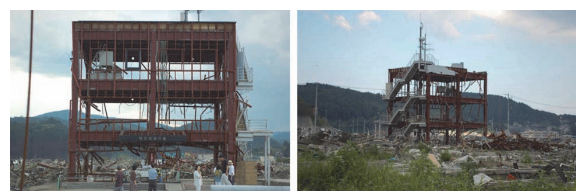
(a) 東面 (b) 北西面 写真10 調査建物の被災状況 (南三陸町)
