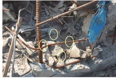
(b) 0-1-A 柱脚 (アンカーボルト破断痕)
