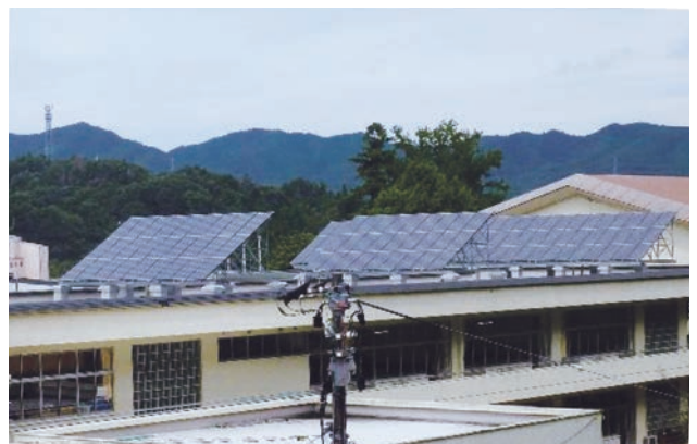
図 3 赤名小学校に設置された太陽電池
