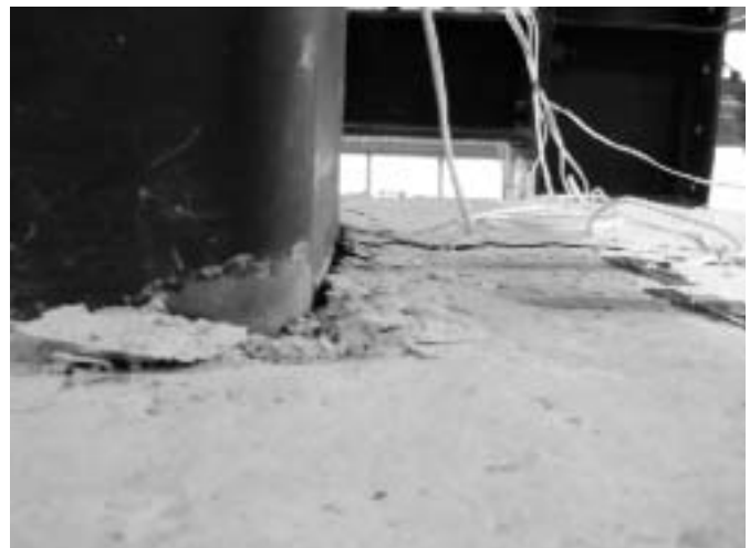
写真1 コンクリートスラブ破壊状況
